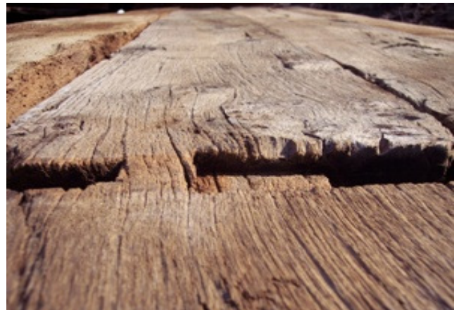
verwitterte Oberfläche, Außenholz
